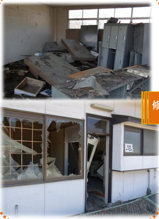
被災訓練施設
