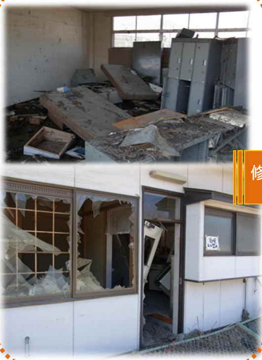
被災訓練施設
