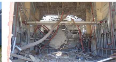
著しく損壊した内部と漂着したマツの巨木(駐車場から観察可)
