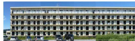
被災後の下宿定住促進住宅(南面全景)
