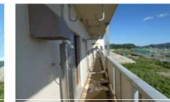
被災後の5階ベランダ部分
