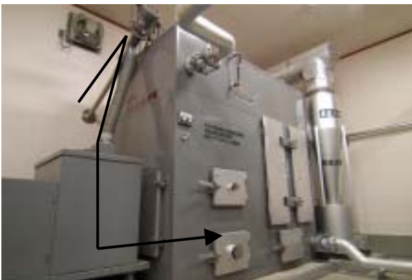
矢印( )はペレットの流れ 屋外に設置してあるペレットサイロから燃料搬送装置(斜めに上昇している部分)により、ボイラー内部へ送り込まれてくる。
