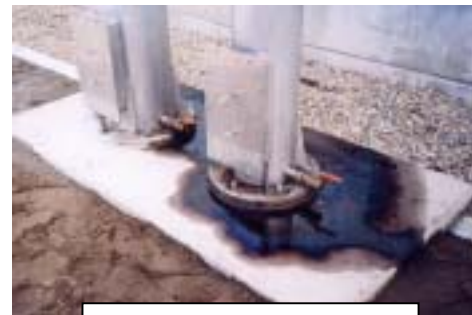
結露により発生した水
