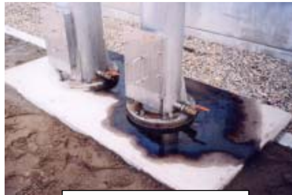
結露により発生した水
