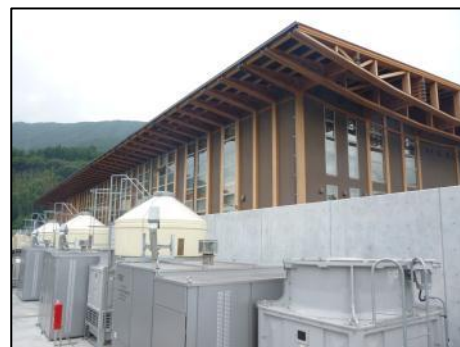
▲3台のペレットボイラー
