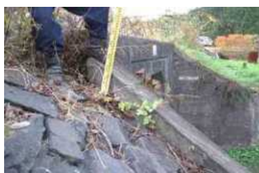
背面盛土は300mm沈下
