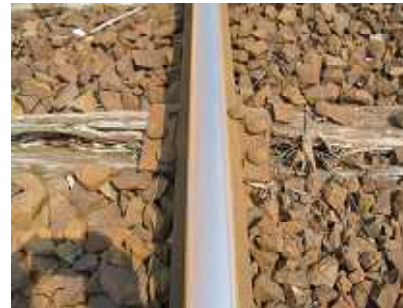
マクラギ腐食（犬釘脱落）
