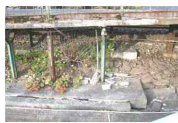
ホーム受台・桁 劣化、錆の侵 食が激しい
