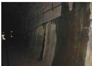
猿渡トンネル(建設S38年) 漏水箇所334箇所。レール等に 影響すると判定:54箇所
