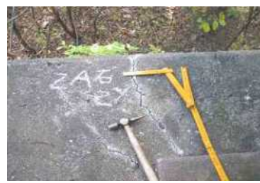
下部工にクラック(判定:安全に対 する影響-将来脅かす)
