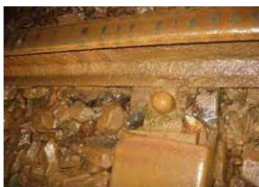
レール磨耗、締結装置腐食
