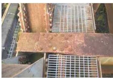
防錆効果失効。立体的に錆が進行 (判定:早急な塗り替え必要)
