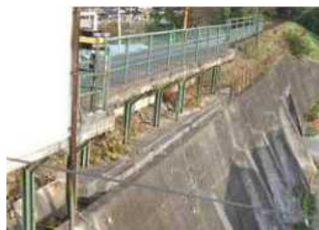
陸前赤崎駅(開業S45年) 土留壁側に乗降場が傾斜
