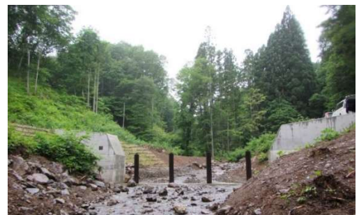
【治山ダム（スリット型）】
